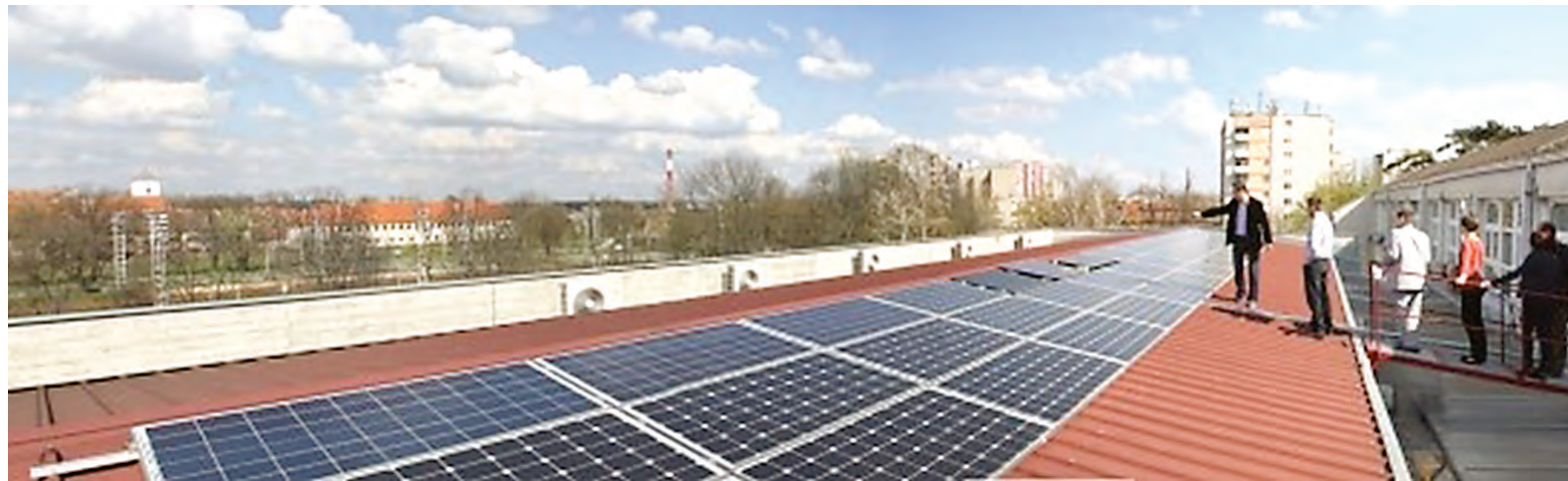
Fotonaponska elektrana na krovu FERIT-a
