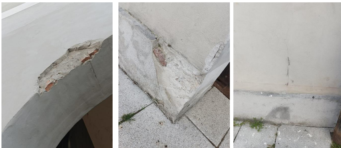
Slike 6, 7, 8: Oštećenje pročelja
